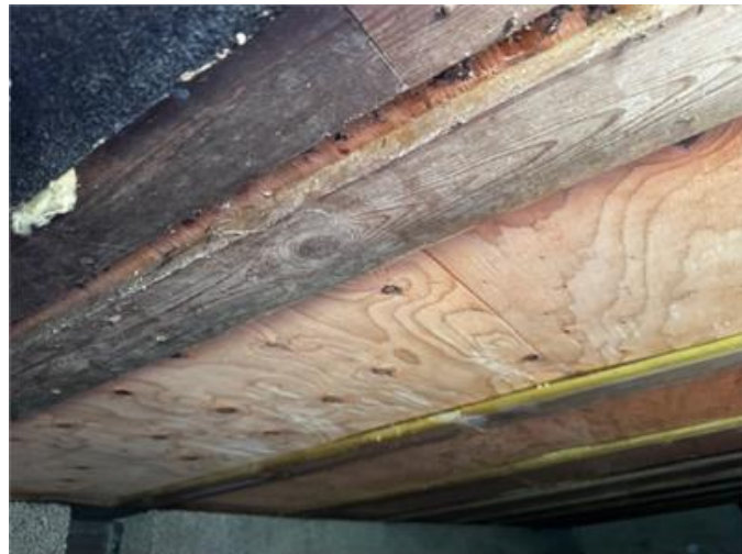
Mikrobiell påväxt i krypgrund utbyggnad.
