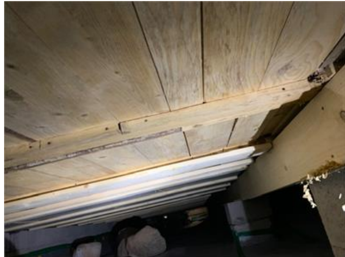
Begynnande påväxt på äldre del av trossbotten. Det noteras även lokalt på de nyare trossbottensnivorna. Väldigt lite men indikerar att det är fuktigt under årets varmaste delar.
