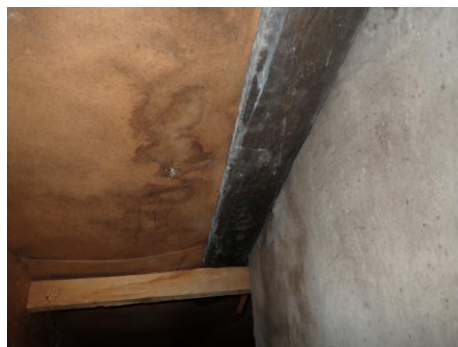
Spår efter gamla läckage runt murstock
