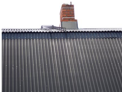
Säker takuppstigning saknas
