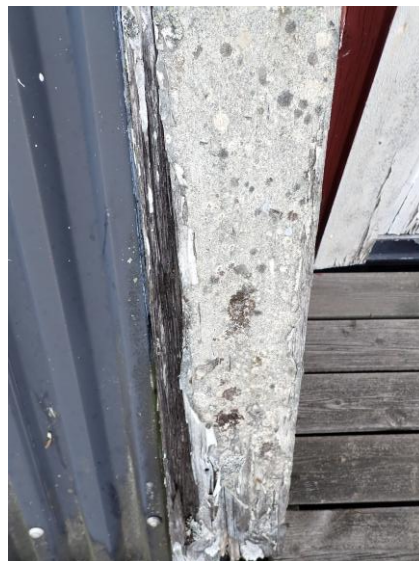
Vattbräda vid balkong rötskadad
