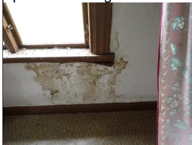
Spår efter läckage under fönster, omfattning av läckage är okänt
