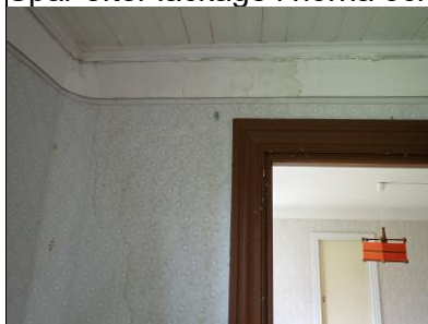
Spår efter läckage i hörna och i vägg mot vardagsrum
