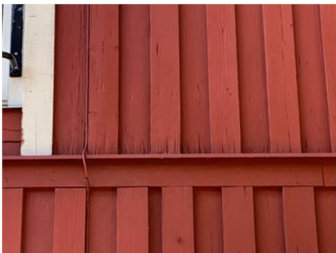
Fasadpanel mot midjeplåt med rötskador/torrspäckor.
