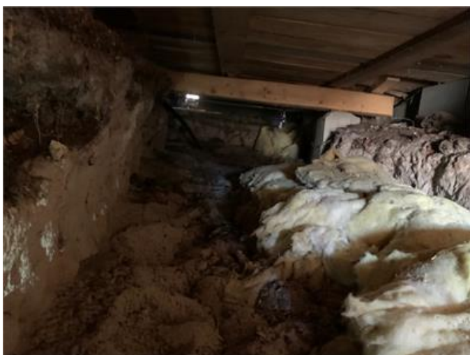
Krypgrund, organiskt material på mark.
