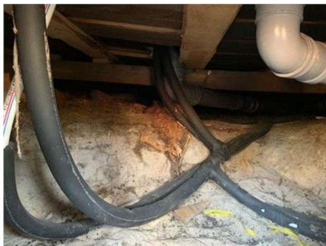
Lösa vattenledningar i krypgrund.
