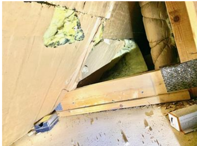
Bild från sidovind där isolering har släppts på något ställe.
