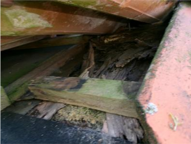
Taktäckningar visar brister samt ålderstecken resp. spår av tidvis takläckage
