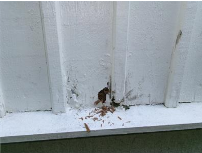
Fuktskador förekommer vid fasader, trädetaljer etc.
