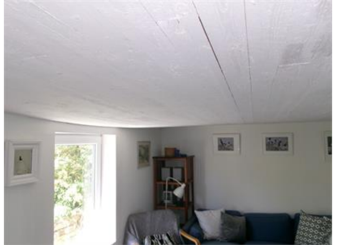
Större svackor förekommer vid ett antal konstruktioner.
