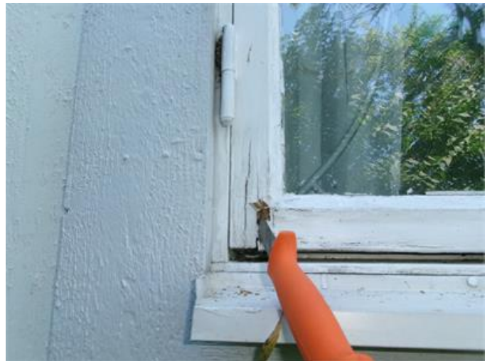
Fuktskador förekommer vid fönster.
