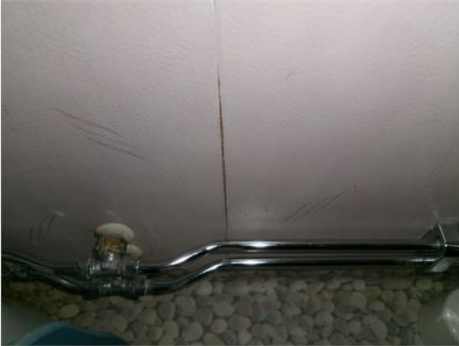
Fastighetens våtrum visar brister resp. risker.
