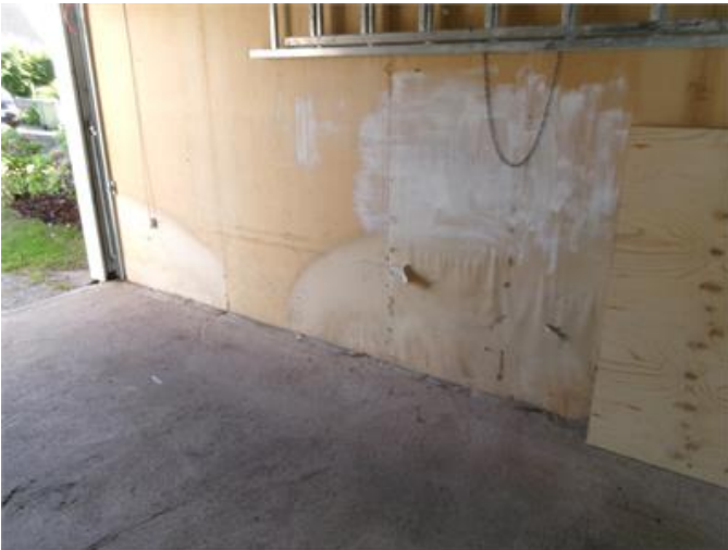
Vid garagebyggnad förekommer spår av fuktskador samt även förhöjda fuktvärden vid väggar, syllregel etc.
