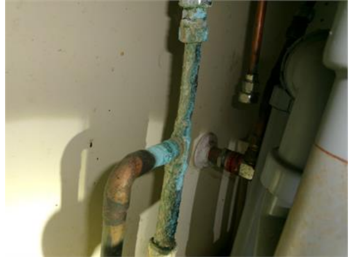
VVS noterades med några ålderstecken resp. risker.
