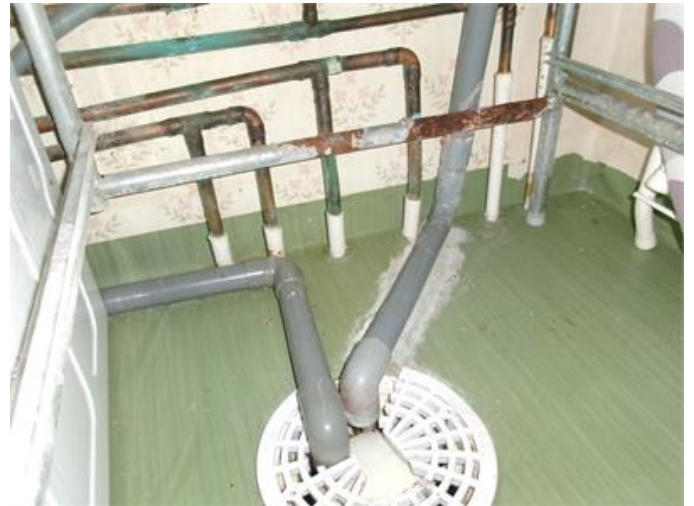
Fastighetens våtrum visar brister resp. risker.
