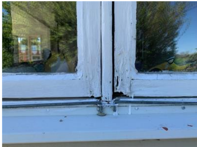
Rötskada i fönsterbåge.
