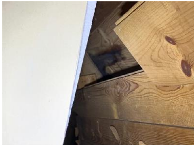
Äldre fuktgenomslag på sidovind.
