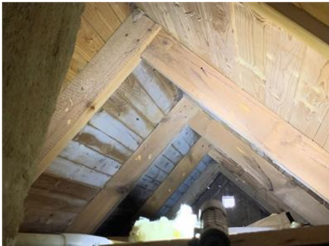
Mikrobiell påväxt på underlagstaket.
