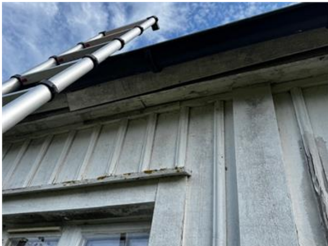
Skada vid takfot.
