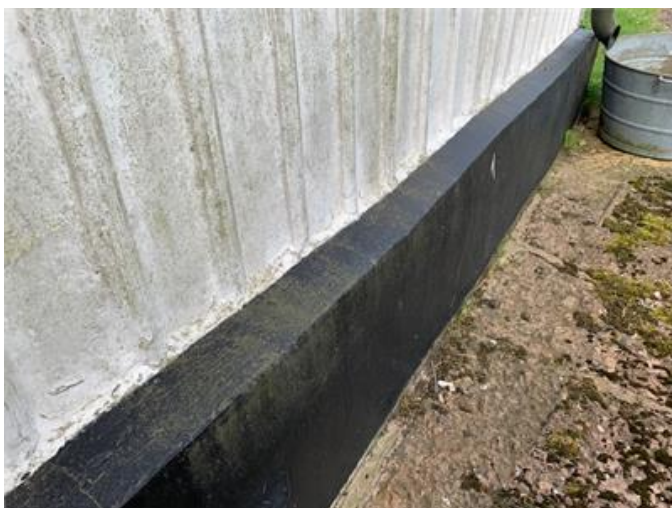
Sockel går utanför fasad vilket ökar risken för fuktuppsug.
