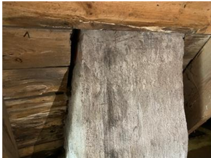
Missfärgning framkant murstock med förhöjd fukt. Äldre fuktfläckar vid sidorna bedöms vara sedan innan taket renoverades och skorstenen plåtbekläddes.
